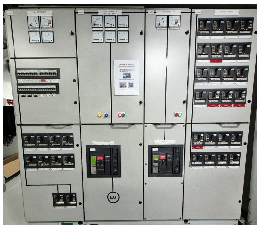
Nødtavle om bord i et supply-skip.
