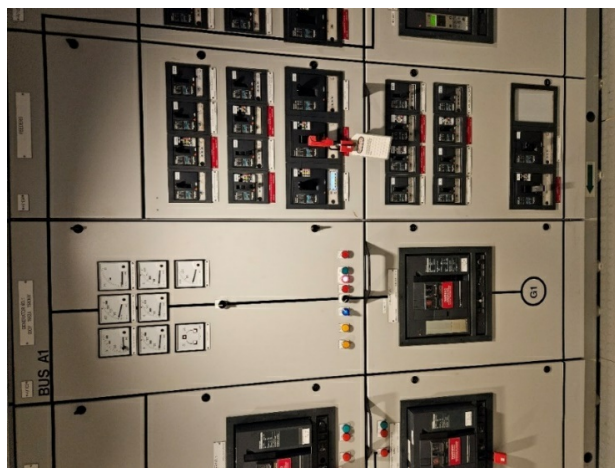
Bilde av et generatorfelt
