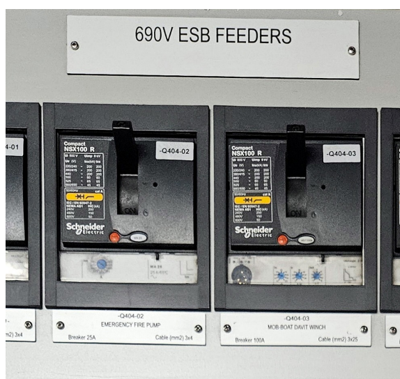
Bilde av utgående kurser i nødtavlen.
