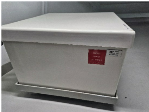
Batteri kasse, nødgenerator.
